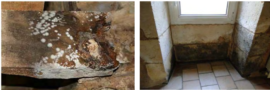
Figure 3 : Illustration des enjeux techniques associés aux risques de pathologie après réhabilitation énergétique (source : STBA)
