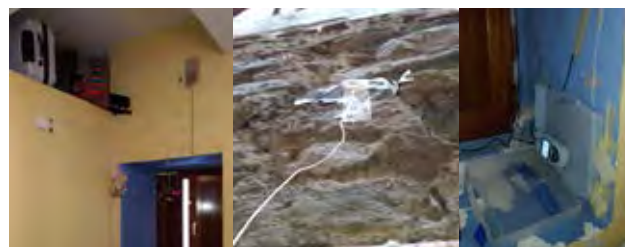
Fluxmètre et sonde superficielle de température intérieure (à gauche), sonde de température de surface extérieure (au centre) et enregistreur de données (à droite).
