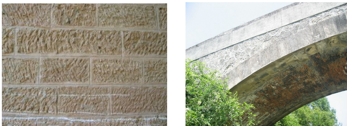
Figure 31 - A droite : PS de la Millette, murs en maçonnerie de moellons à joints incertains (opus incertum), bandeau en pierre de taille, corps de voûte en briques. A gauche : Pont de Montsalvy, détail de maçonnerie à moellons smillés à assise horizontale.
