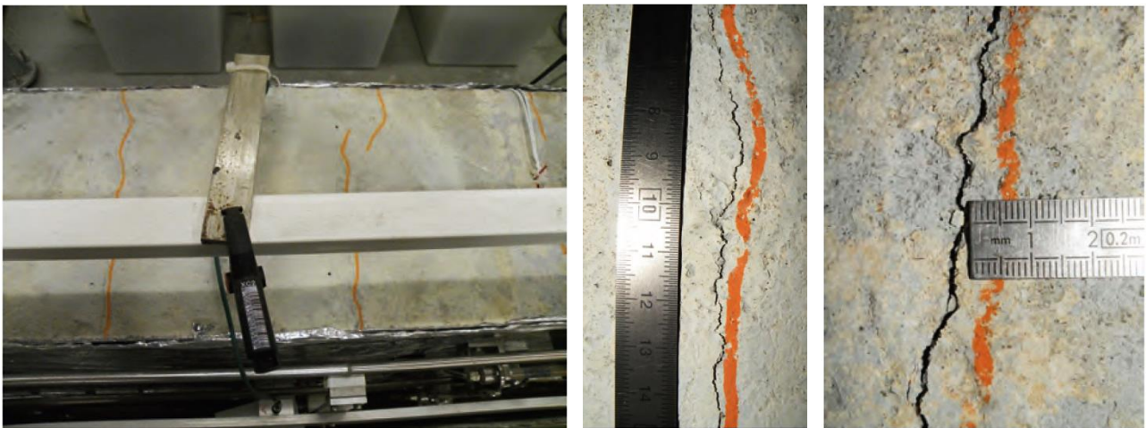
Figure 1-18. Fissuration transversale supérieure de la poutre fortement armée (Martin, 2010).
